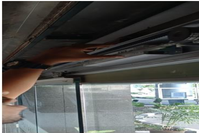
Gambar 15 Pengecekan kekencangan dan kondisi fisik van belt
