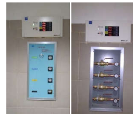
Gambar 11 Box valve dan Alarm gas
