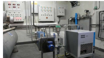
Gambar 6 Mesin Air Dryer
