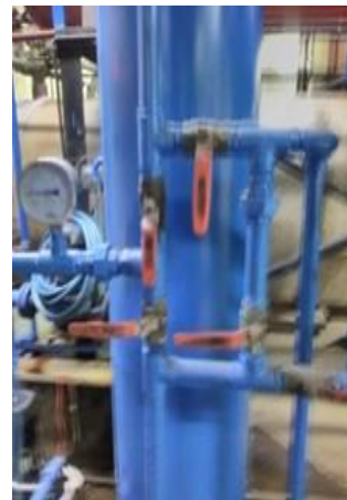
Gambar 4 Stop keran pada water treatment
