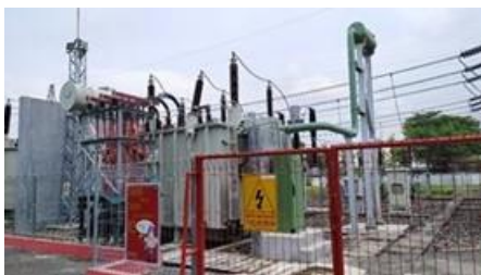
Gambar 3 Transformator dengan proteksi sergi
